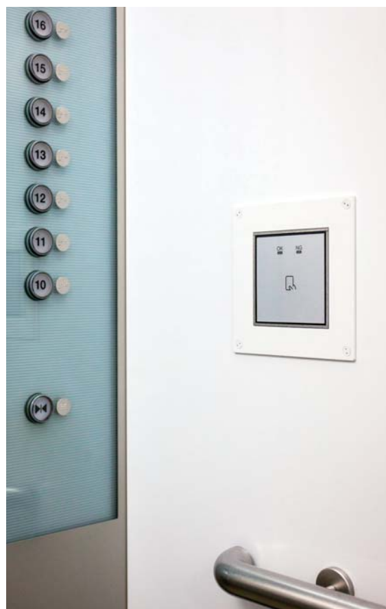
▶かご室の壁面に設置されたカードリーダー。ICカードをかざして利用する。
