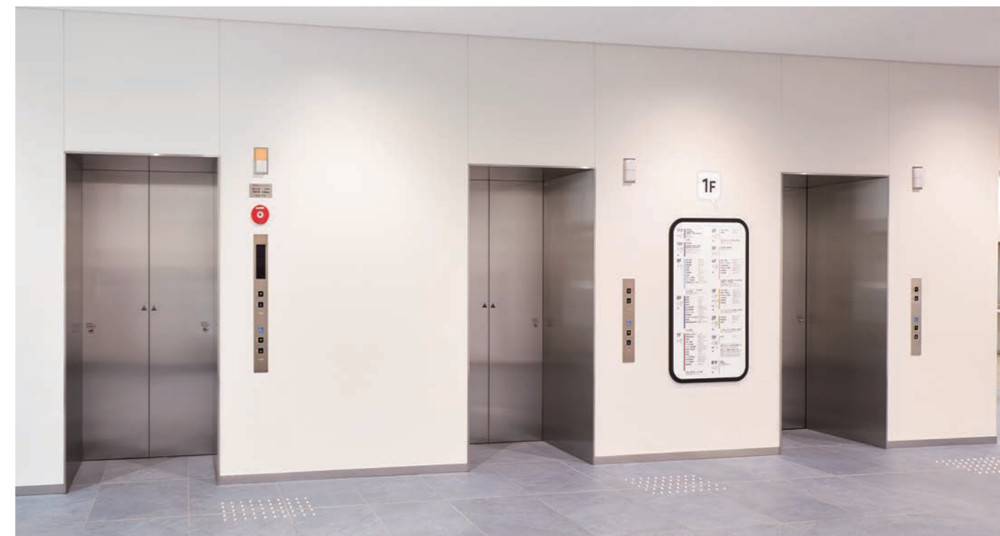
乗用(非常用)/乗用17人乗りエレベーター(職員用)・1階
