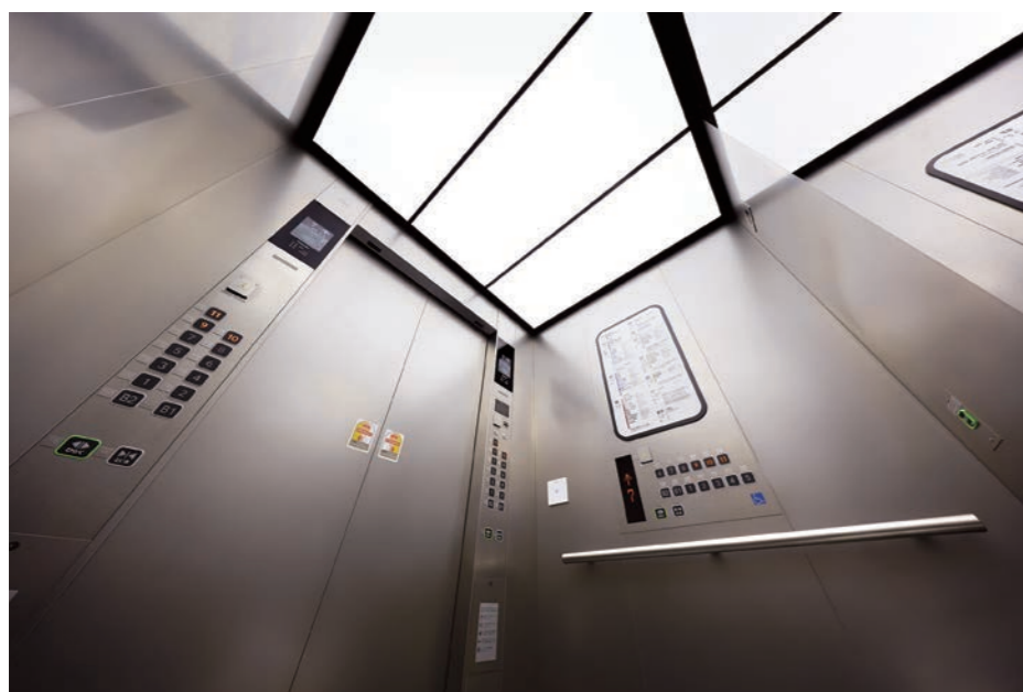
乗用(非常用)17人乗りエレベーター(来庁者用)・かご室天井
