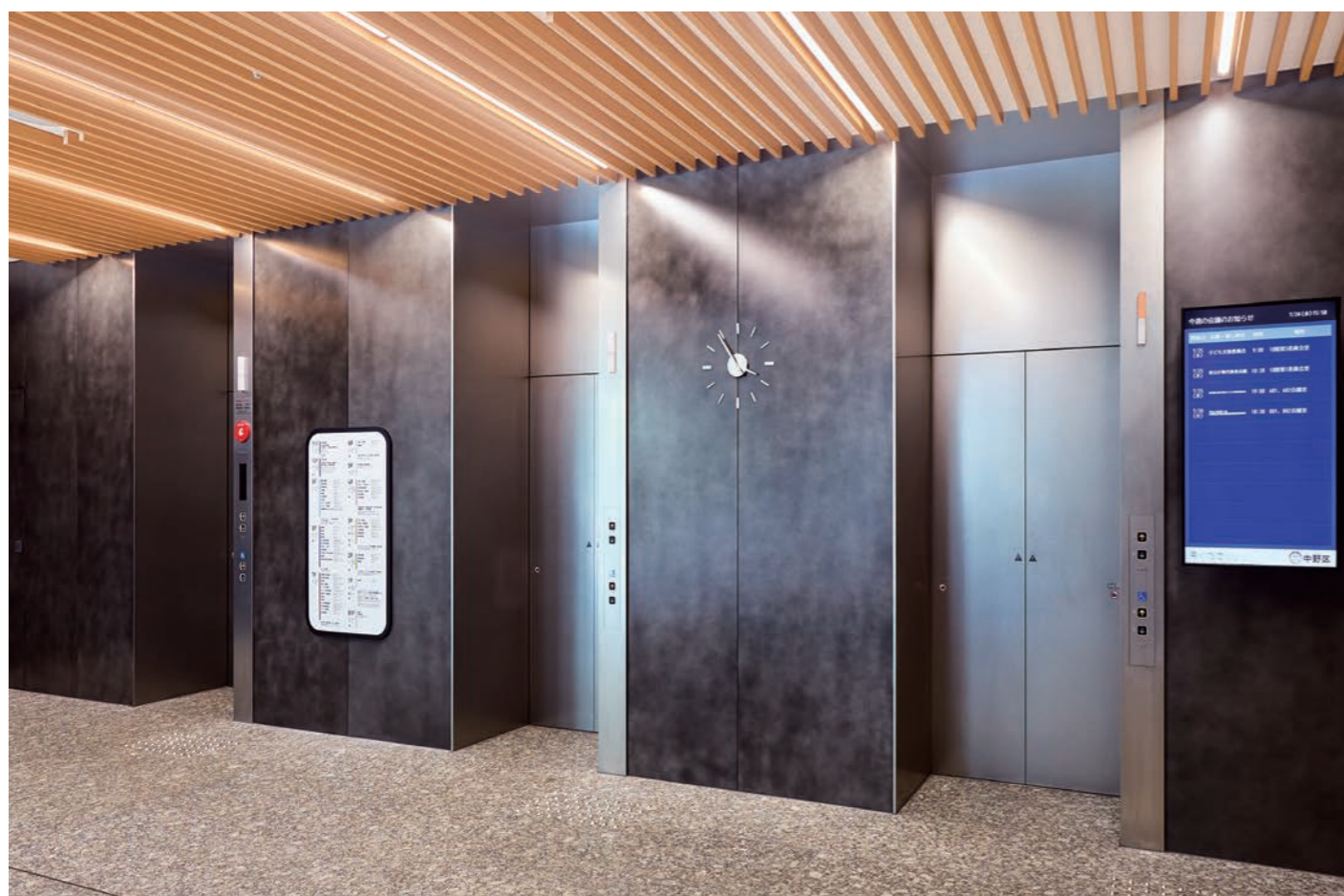
乗用(非常用)/乗用17人乗りエレベーター(来庁者用)・1階
