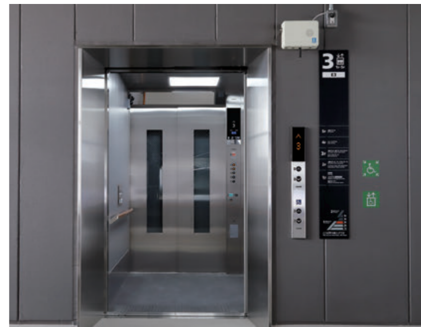
乗用24人乗りエレベーター(避難兼用:災害時に歩行困難者等の避難用として、利用することを想定しています。)
