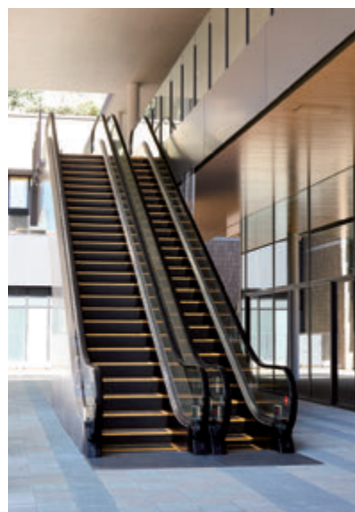
エスカレーター・1階
