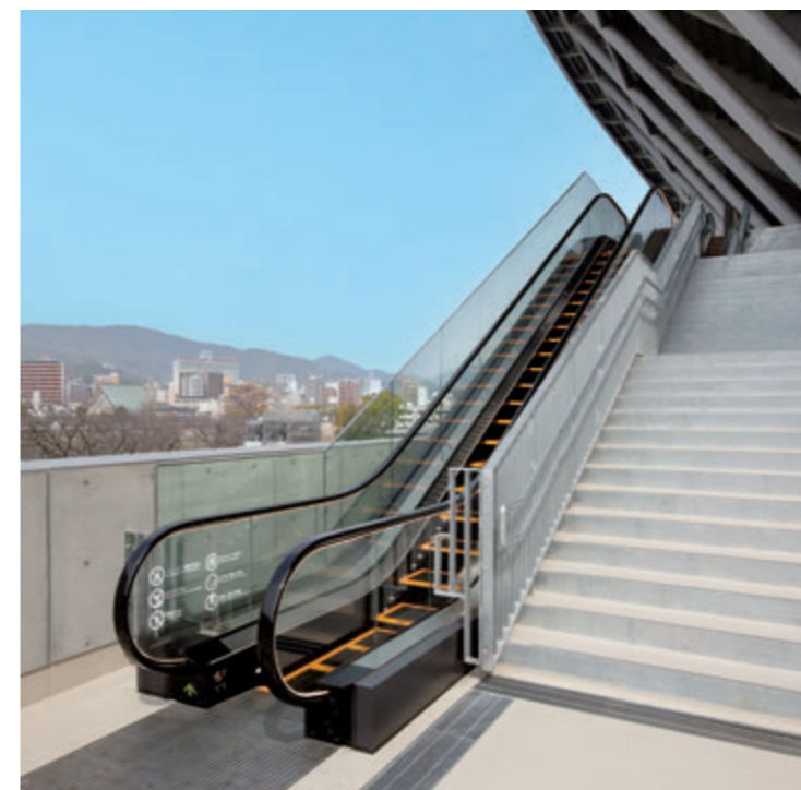
エスカレーター・3階
