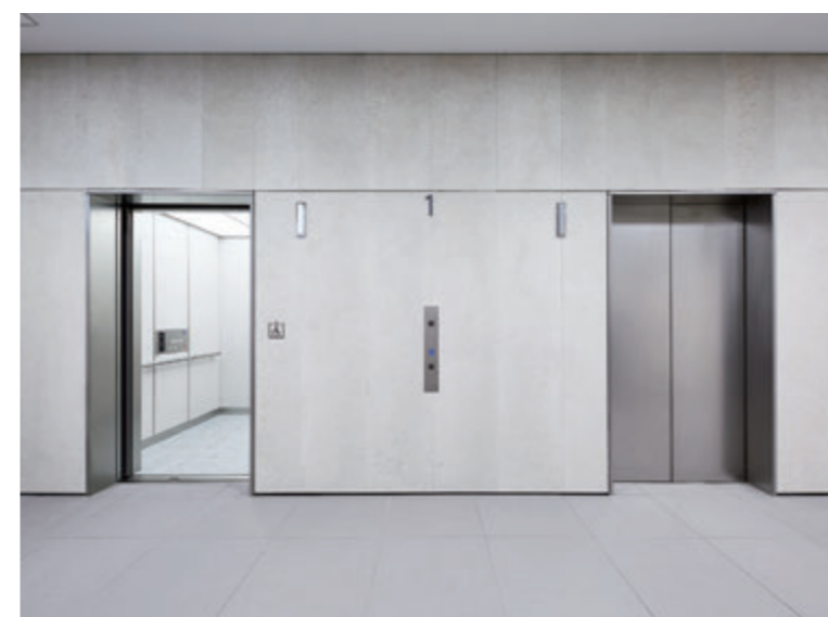
乗用20人乗りエレベーター・北館1階
