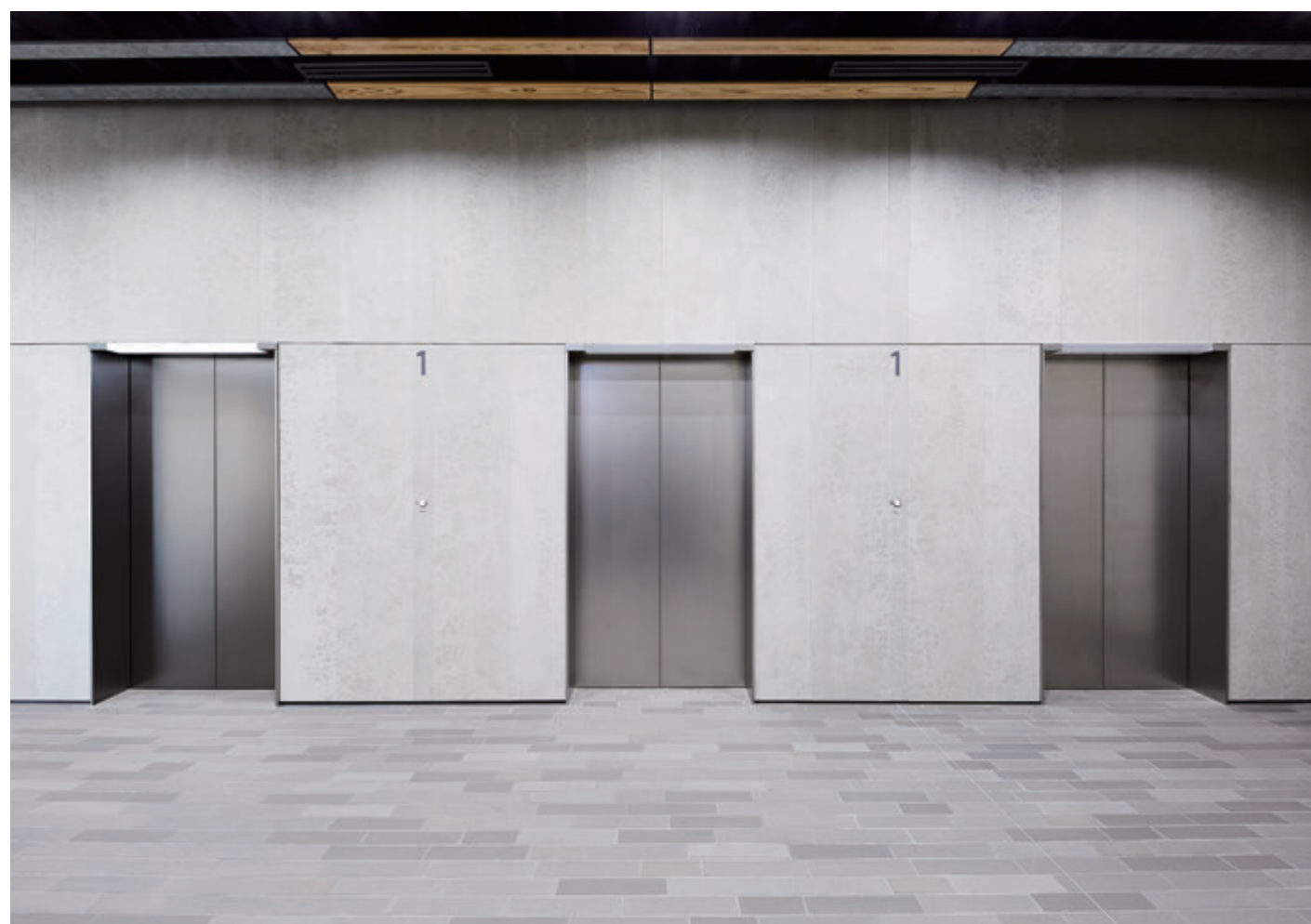
乗用20人乗りエレベーター・南館1階
