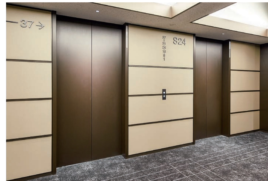
乗用24人乗りエレベーター・24階ホール(S棟 高層バンク リニューアル後)
