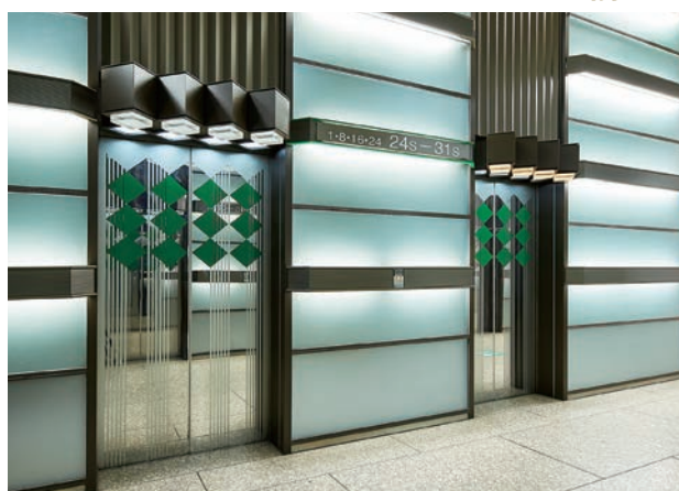
乗用24人乗りエレベーター・1階ホール(S棟 中層バンク リニューアル前)
