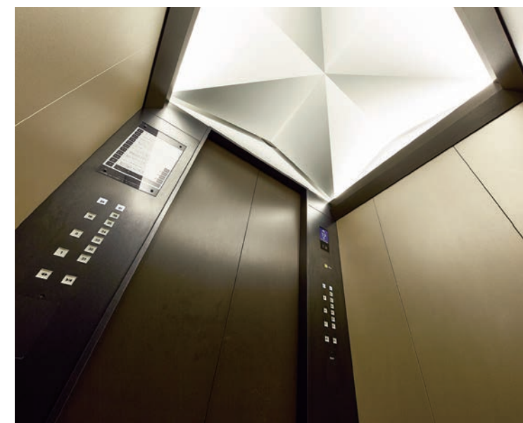
乗用24人乗りエレベーター・かご室天井(S棟 高層バンク リニューアル後)
