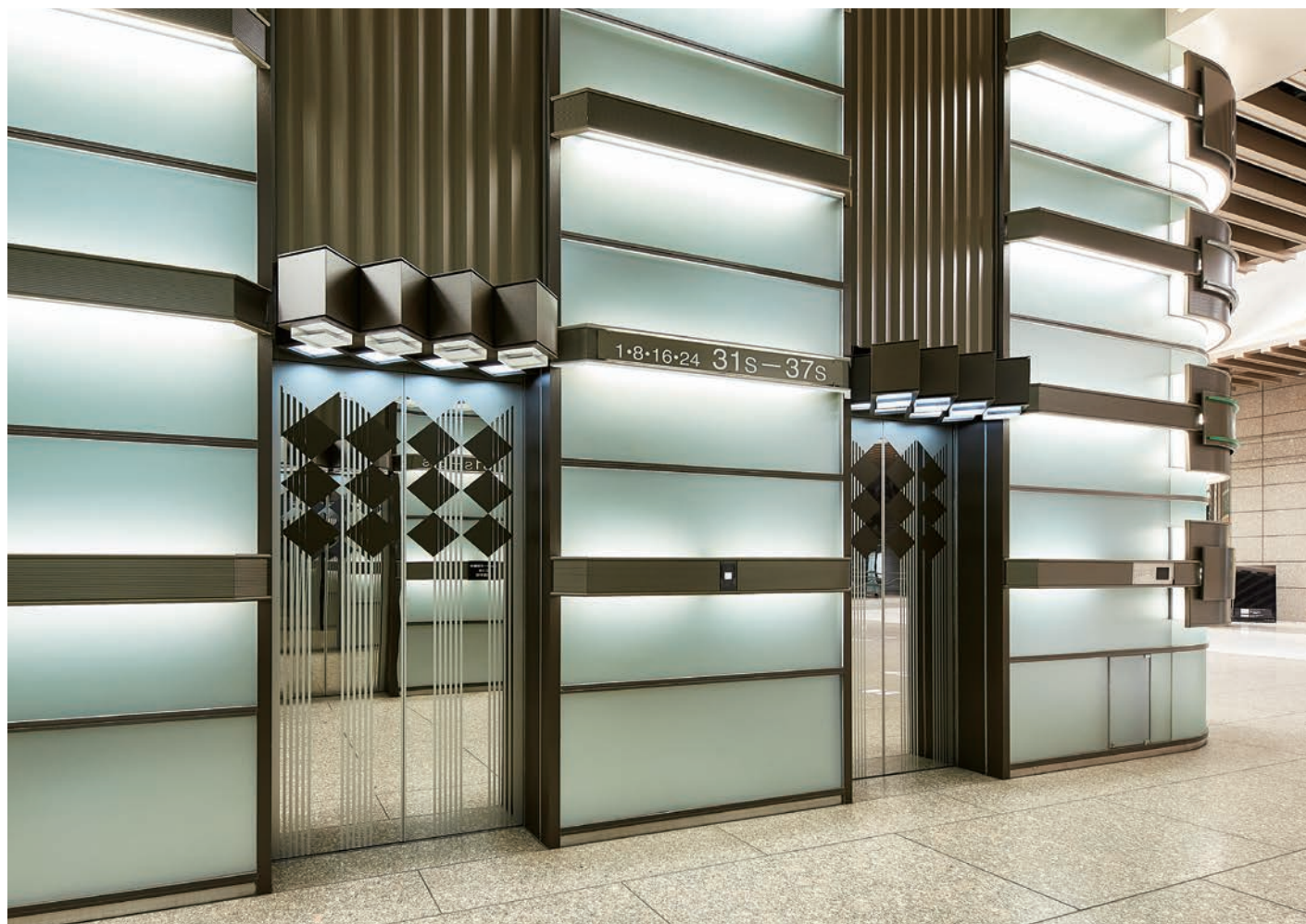
乗用24人乗りエレベーター・1階ホール(S棟 高層バンク リニューアル後) のりばドアも竣工当時のデザインに合わせてリニューアルしています。
