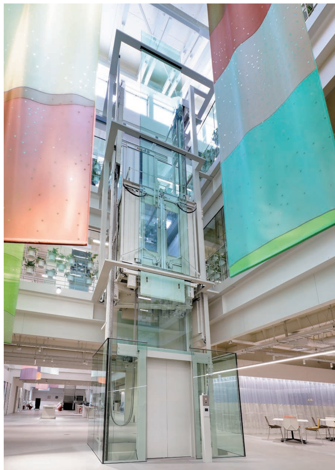
乗用24人乗りエレベーター・昇降路
