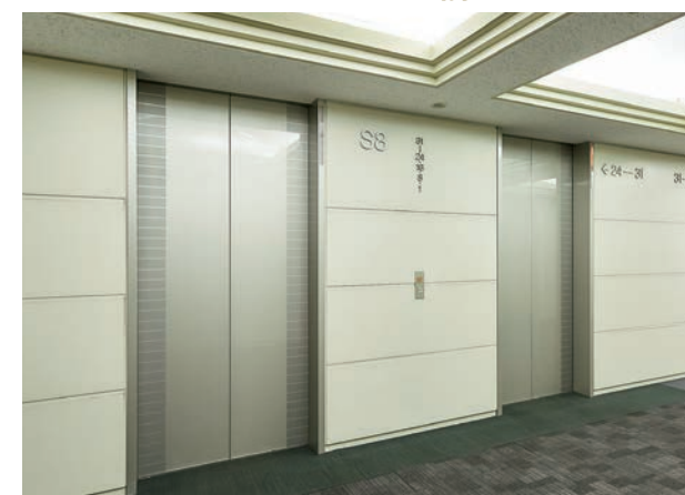
乗用24人乗りエレベーター・8階ホール(S棟 中層バンク リニューアル前)
