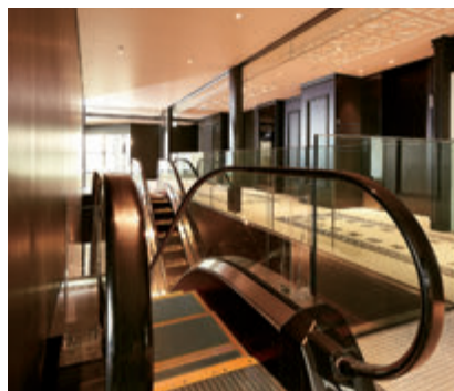
エスカレーター/乗用15人乗りエレベーター・3階
