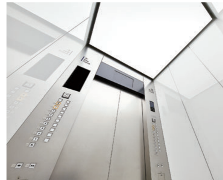
乗用24人乗りエレベーター・かご室天井(リニューアル後)
