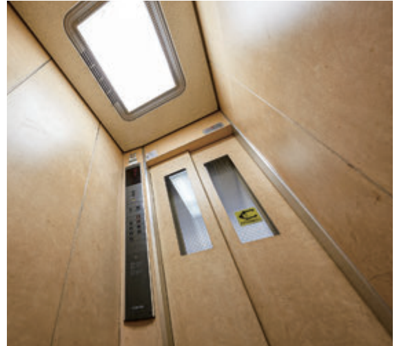
住宅用9人乗り(トランク付)エレベーター・かご室天井(リニューアル前)
