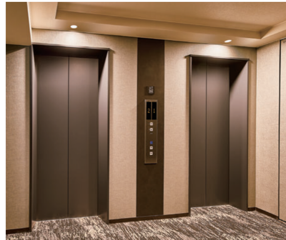
乗用11人乗りエレベーター・2階ホール
