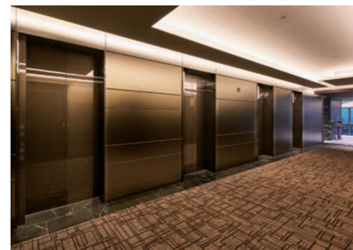
乗用27/24人乗りエレベーター・25階ホール
