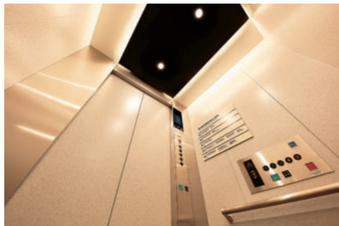
乗用13人乗りエレベーター・かご室天井
