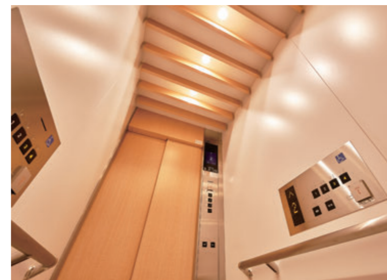
乗用13人乗りエレベーター・かご室天井
