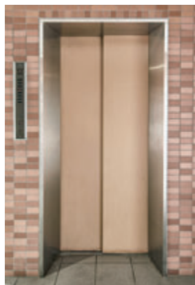
住宅用9人乗り(トランク付)エレベーター・1階ホール(リニューアル前)
