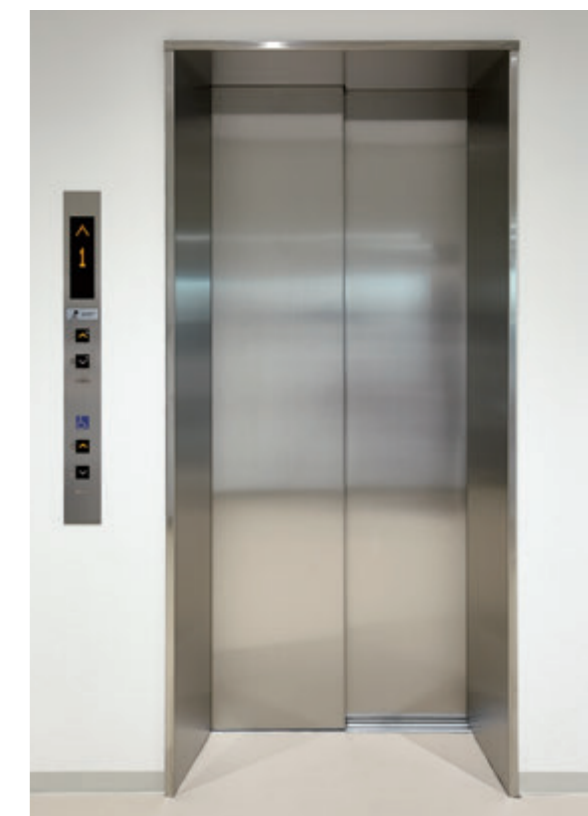
乗用13人乗りエレベーター・3階ホール
