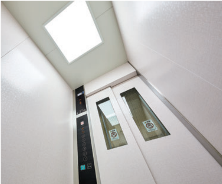
住宅用9人乗り(トランク付)エレベーター・かご室天井(リニューアル後)
