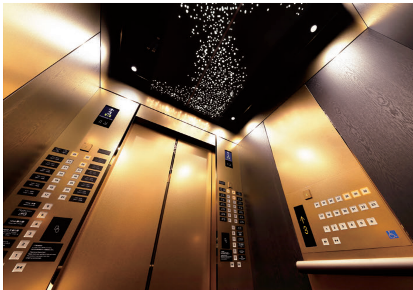
乗用20人乗りエレベーター・かご室天井(リニューアル後)
