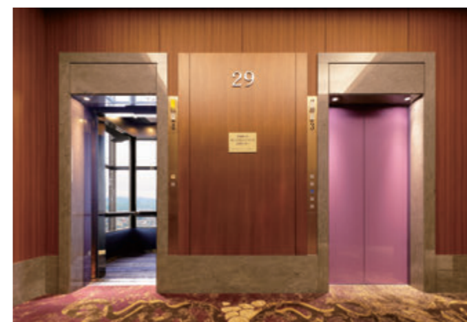
乗用(展望用)15人乗り(左)/乗用20人乗りエレベーター(右) 29階ホール(リニューアル後)
