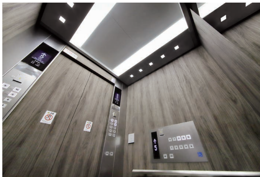
乗用15人乗りエレベーター・かご室天井(来客用)
