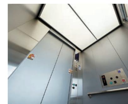
乗用(展望用)15人乗りエレベーター・かご室天井
