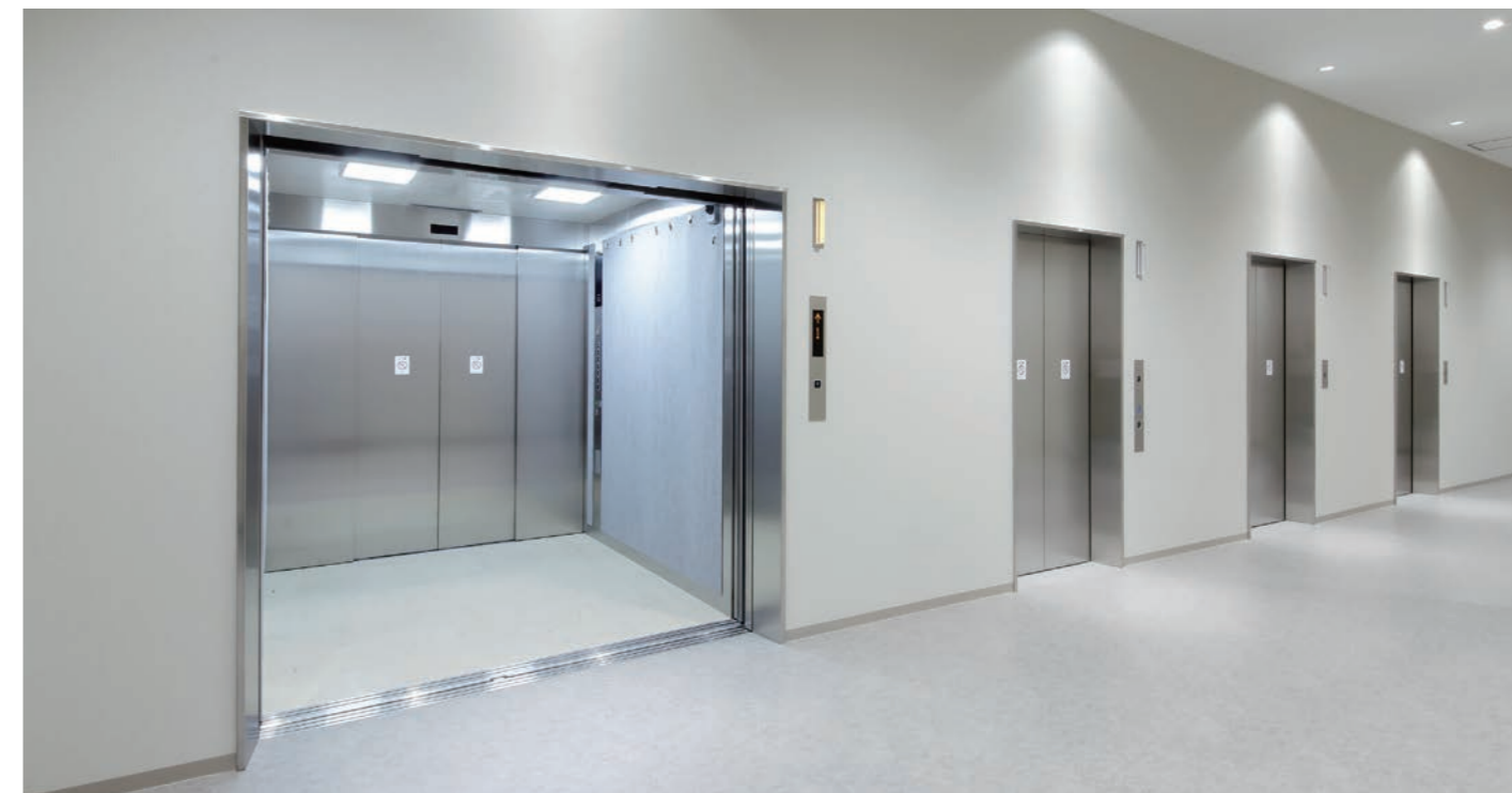
人荷用30人乗り/乗用15人乗りエレベーター・1階のりば(従業員用)
