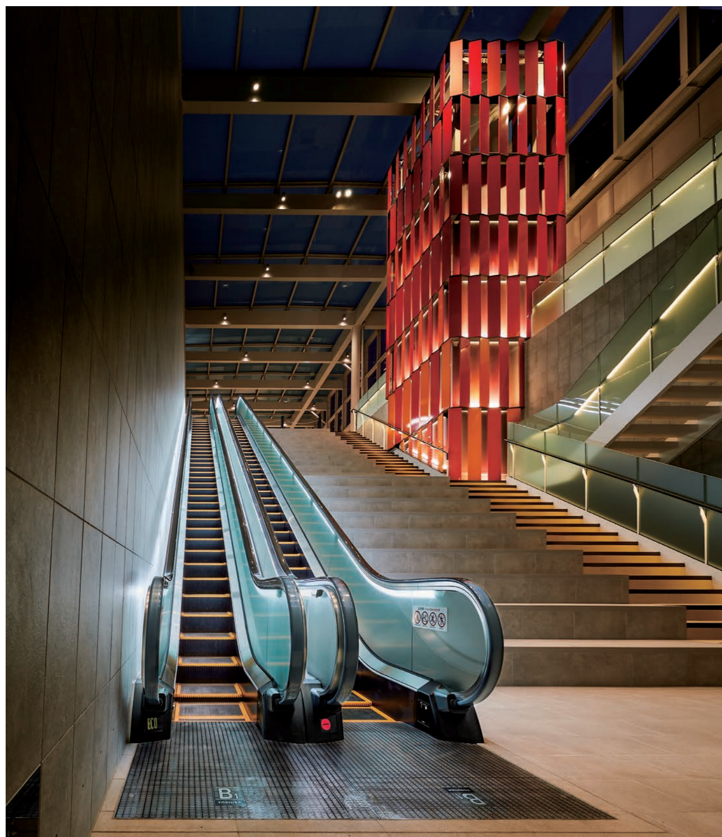
乗用13人乗りエレベーター昇降路・エスカレーター (古町ルフル広場)
