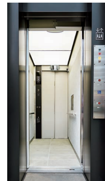
乗用13人乗りエレベーター・かご室 (古町ルフル広場)
