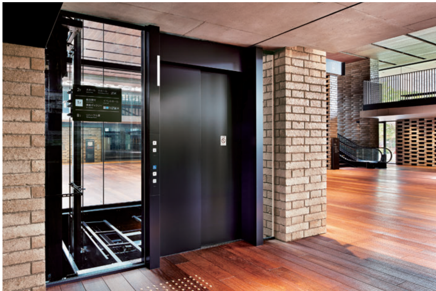
乗用(展望用)26人乗りエレベーター・1階ロビー
