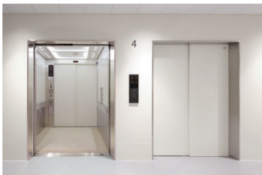
寝台用17人乗りエレベーター・4階のりば・かご室
