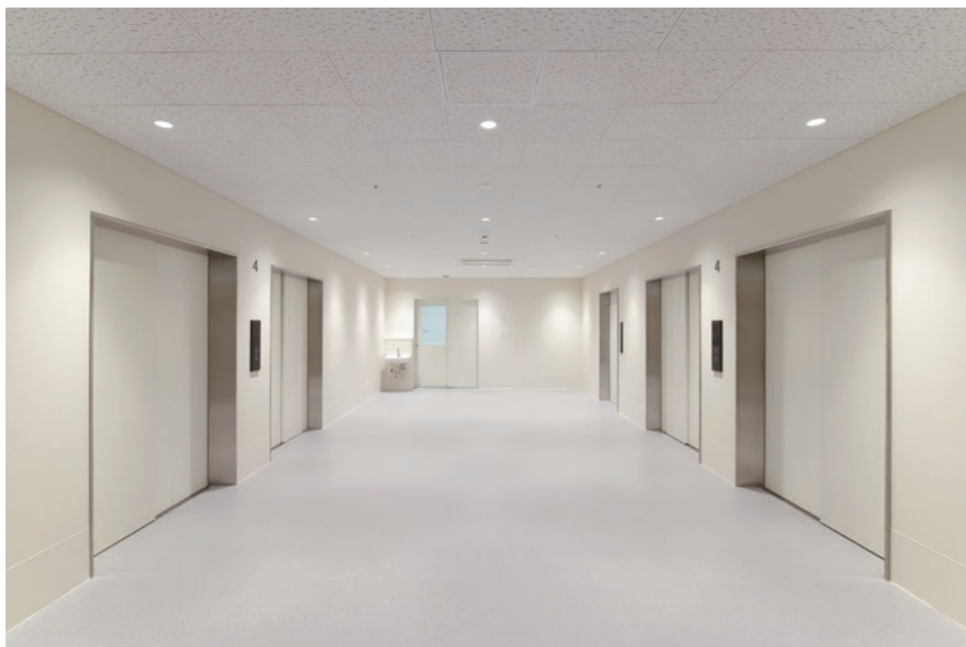
寝台用17人乗り/人荷用22人乗りエレベーター・4階ホール
