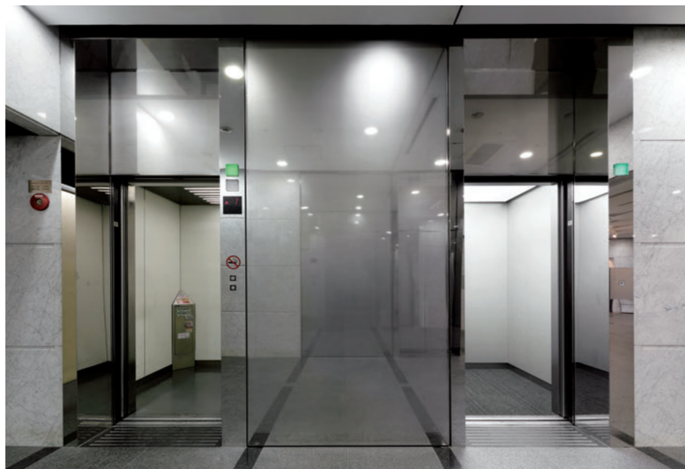
乗用(非常用)17人乗りエレベーター(左:リニューアル前)/乗用13人乗りエレベーター(右:リニューアル後) 1階ホール
