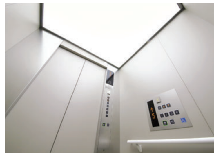
乗用15人乗りエレベーター・かご室天井
