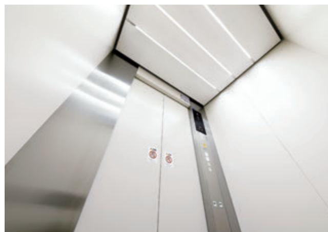
乗用9人乗りエレベーター・かご室天井
