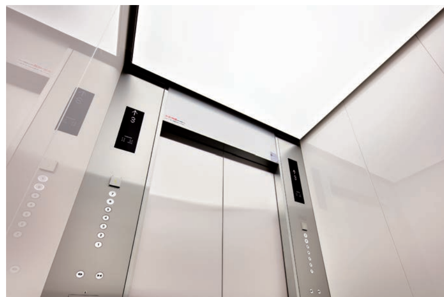
乗用20人乗りエレベーター・かご室天井
