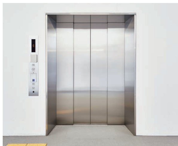
人荷用24人乗りエレベーター・4階のりば
