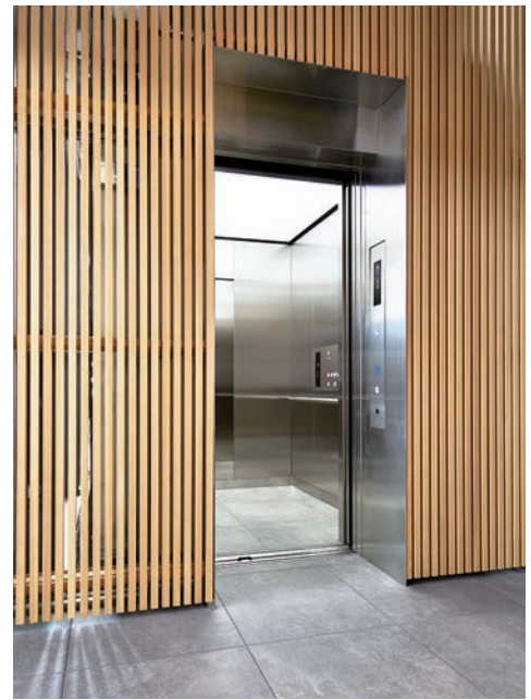
乗用15人乗りエレベーター・1階のりば かが室
