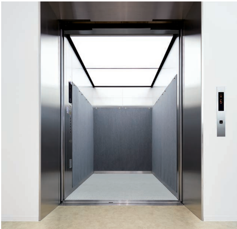
人荷用30人乗りエレベーター・6階のりば かが室
