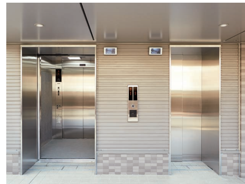
乗用20人/住宅用13人乗りエレベーター・1階エレベーターホール
