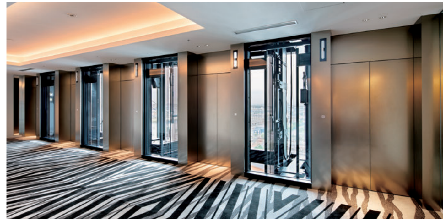
展望用20人乗りエレベーター・14階エレベーターホール
