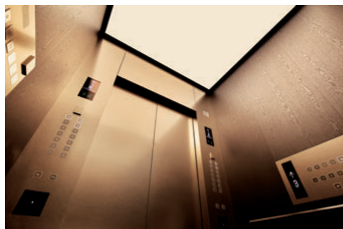
展望用20人乗りエレベーター・かご室天井
