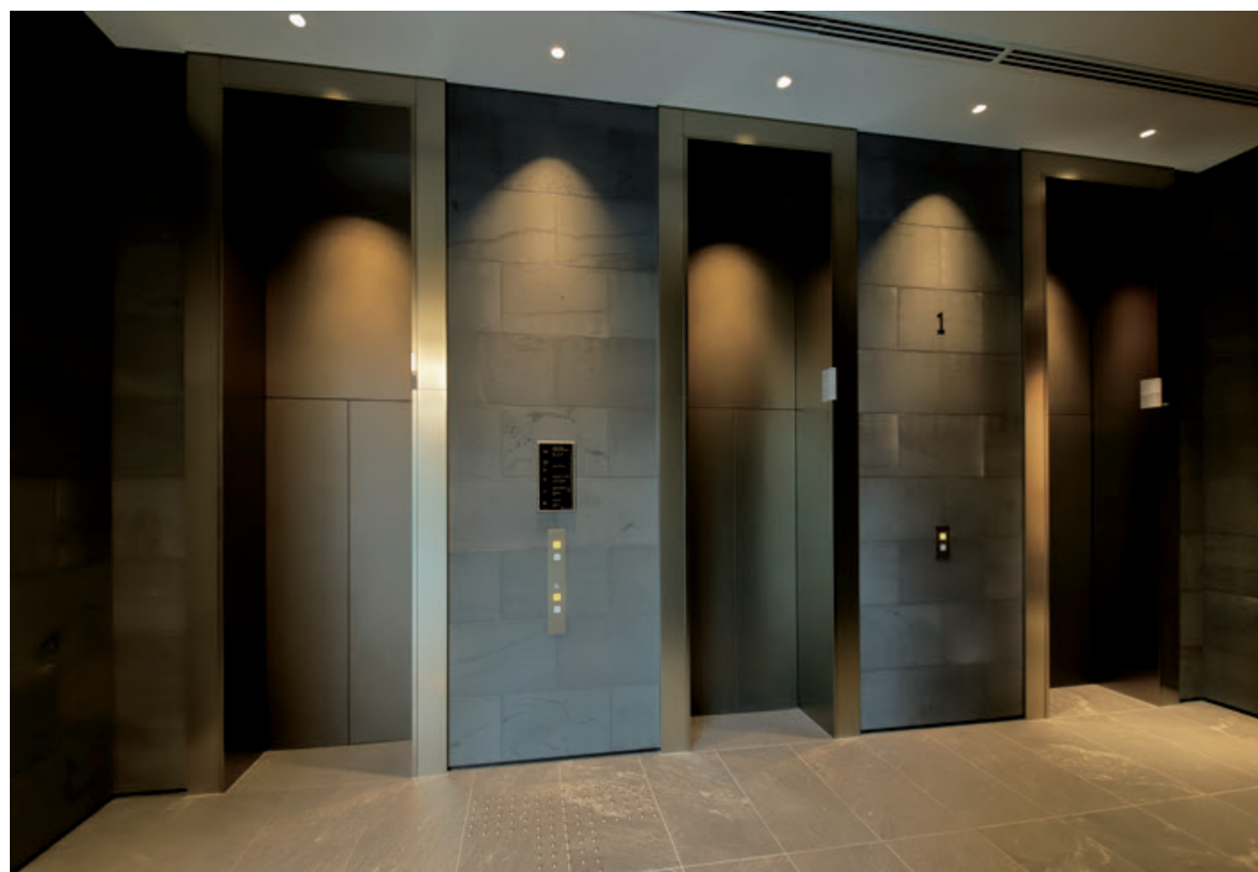
乗用15人乗りエレベーター・1階エレベーターホール
