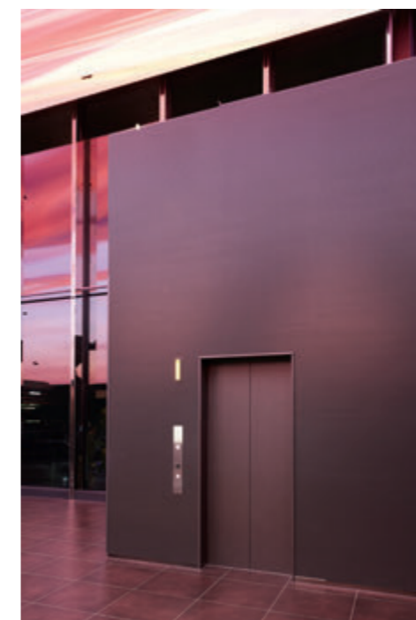
乗用15人乗りエレベーター・14階エレベーターホール
