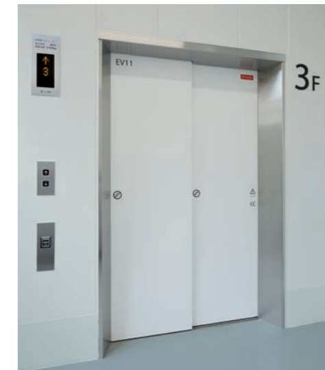
人荷用(兼非常用)26人乗りエレベーター・3階のりば
