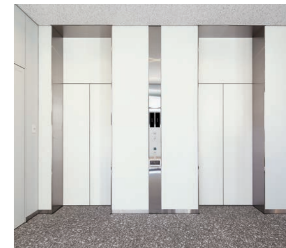
乗用15人乗り／乗用20人乗りエレベーター・1階エレベーターホール
