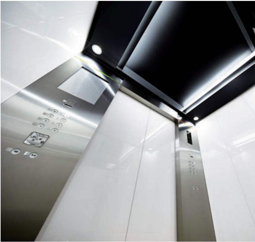
乗用24人乗りエレベーター・かご室天井(リニューアル後)
