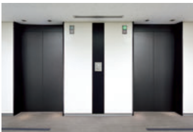
乗用24人乗りエレベーター・7階ホール
