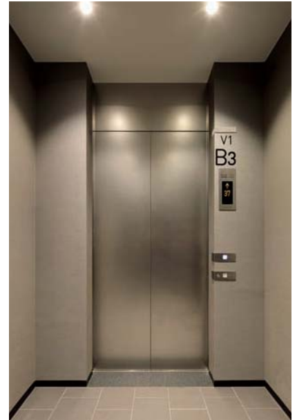
人荷用(兼非常用)17人乗りエレベーター(V1)・地下3階のりば
