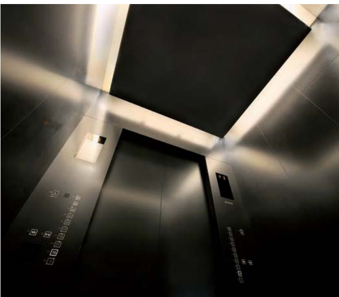
乗用30人乗りエレベーター・かご室天井
