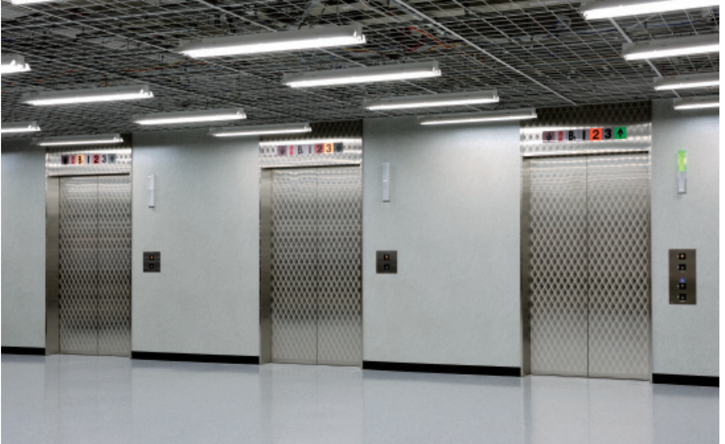
乗用24人乗りエレベーター・2階ホール
