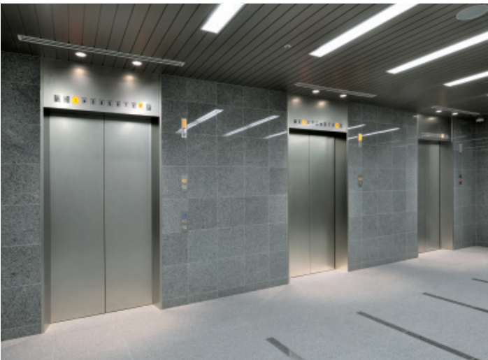
乗用20人乗りエレベーター・3階ホール(オフィス用)
