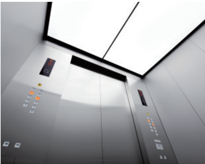
乗用エレベーター・かご室天井
