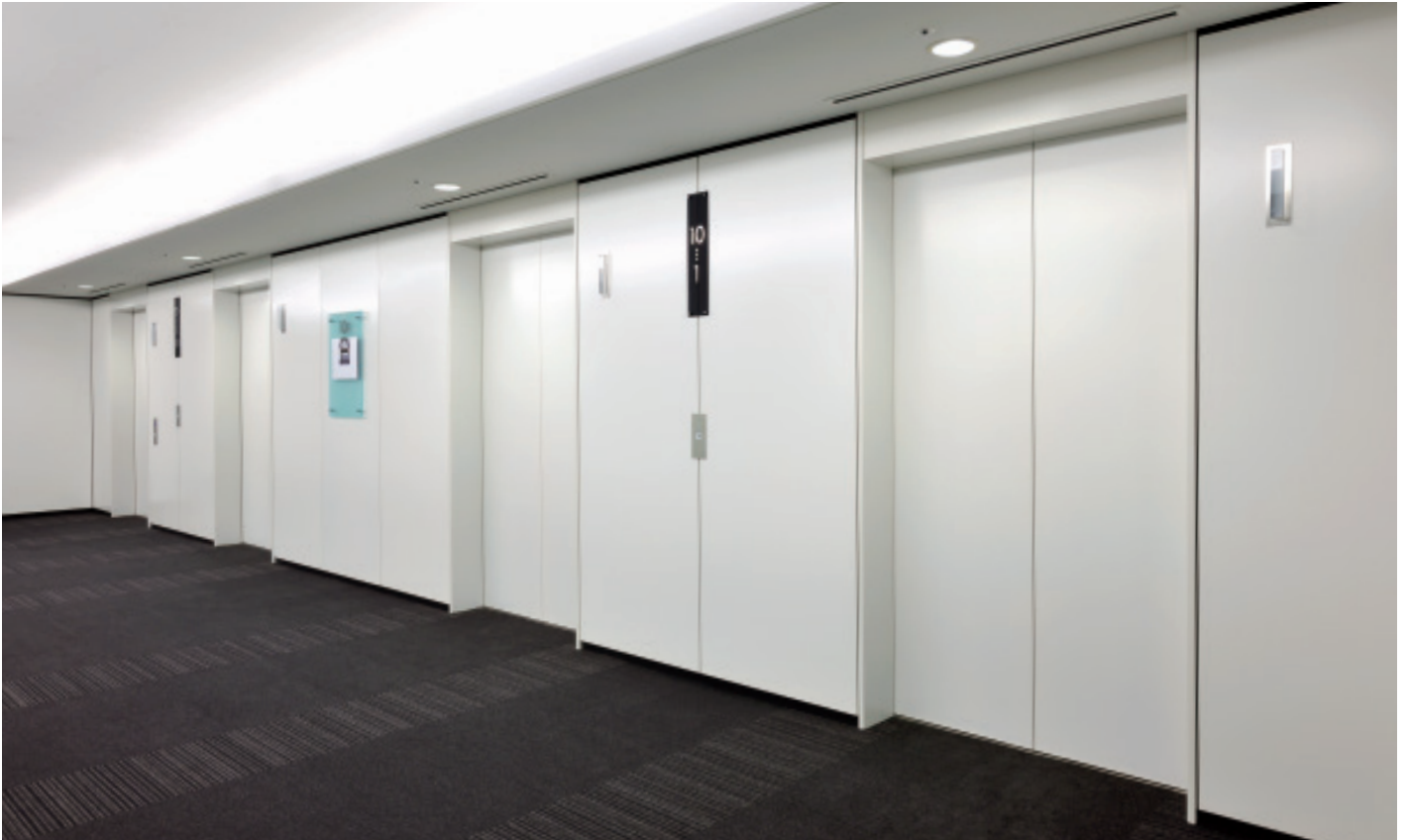
乗用エレベーター・10階ホール
