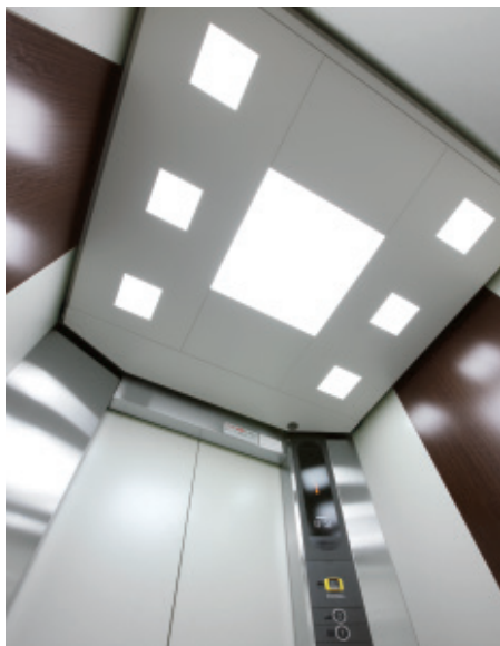
乗用エレベーター・かご室天井
