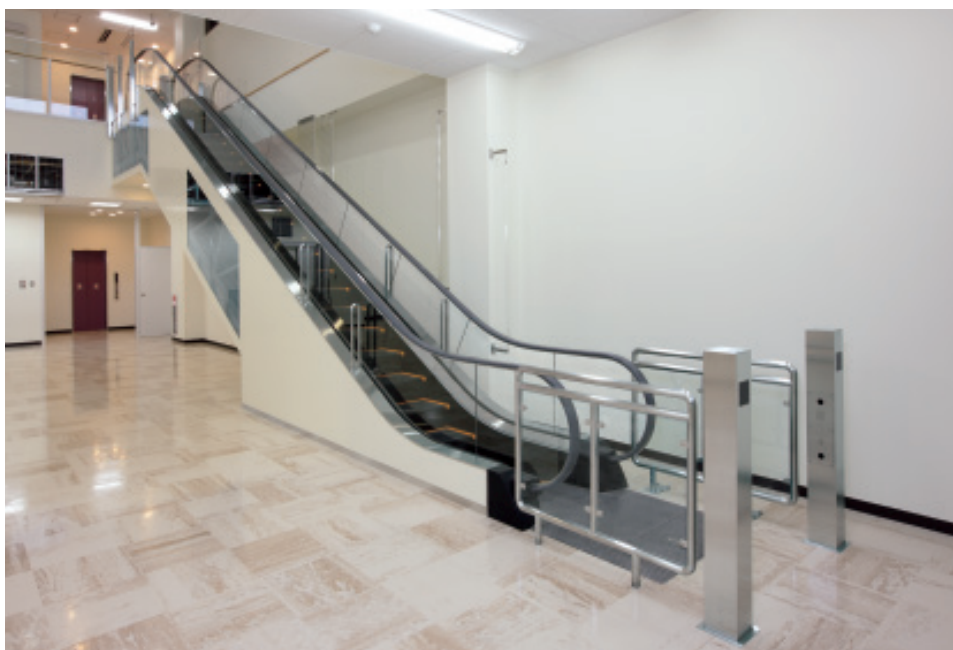
エスカレーター外観と乗用エレベーターのりば
