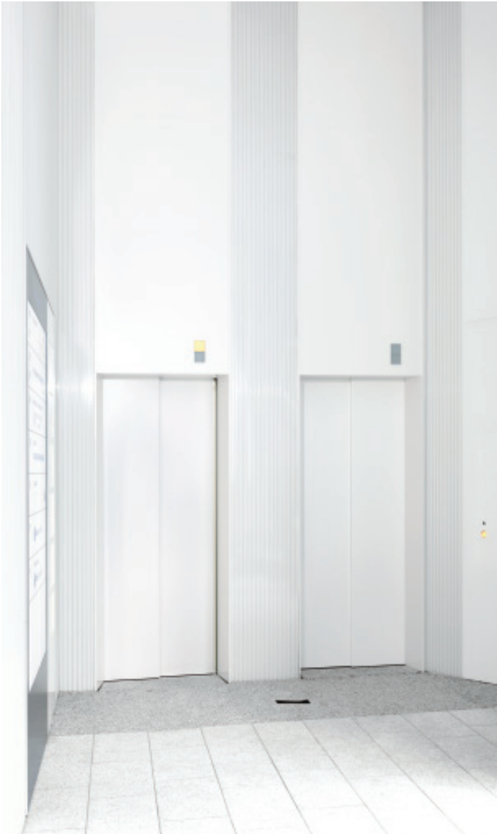
乗用エレベーター・1階ホール
