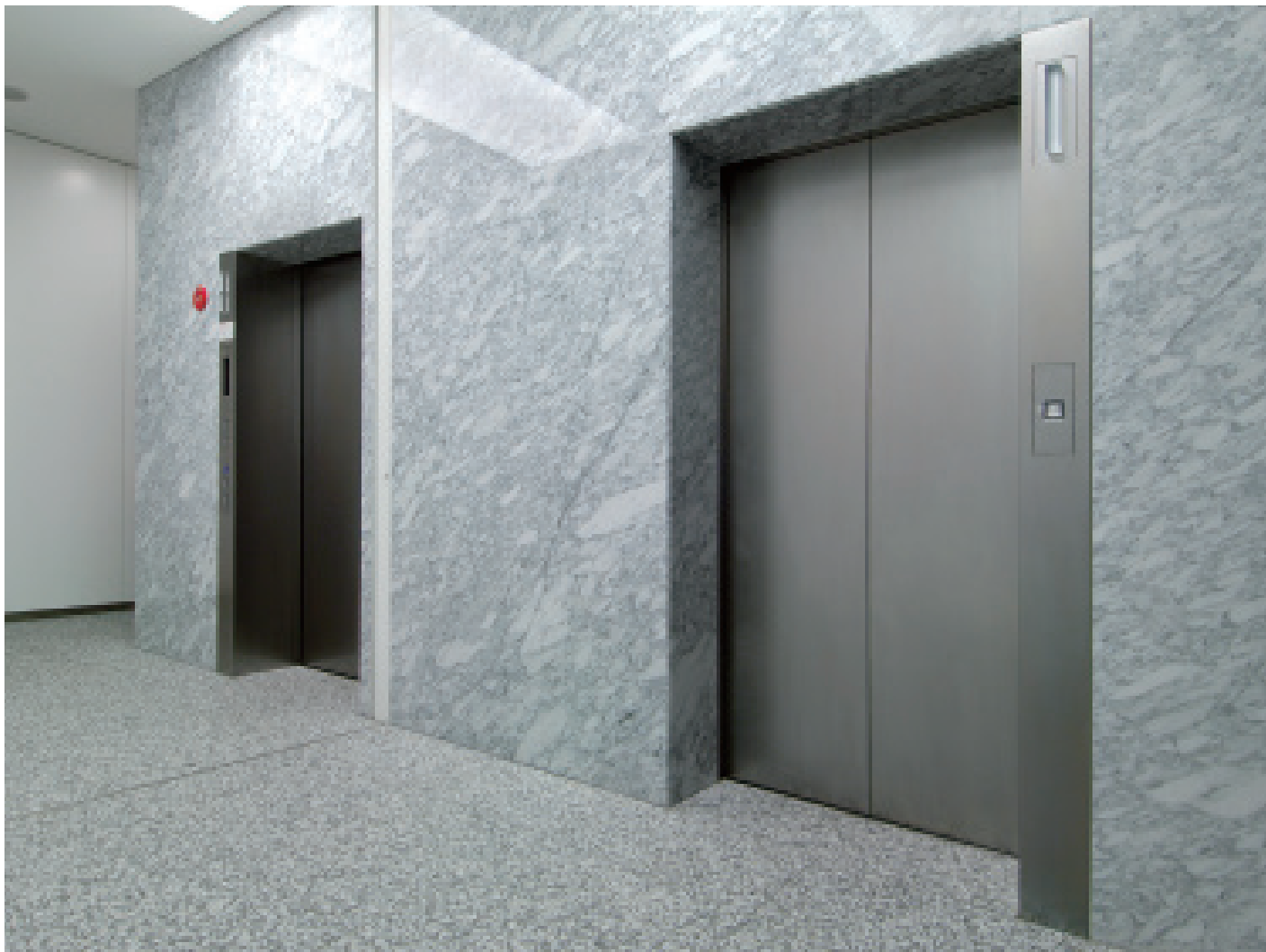
乗用 17人乗りエレベーター・1階ホール
