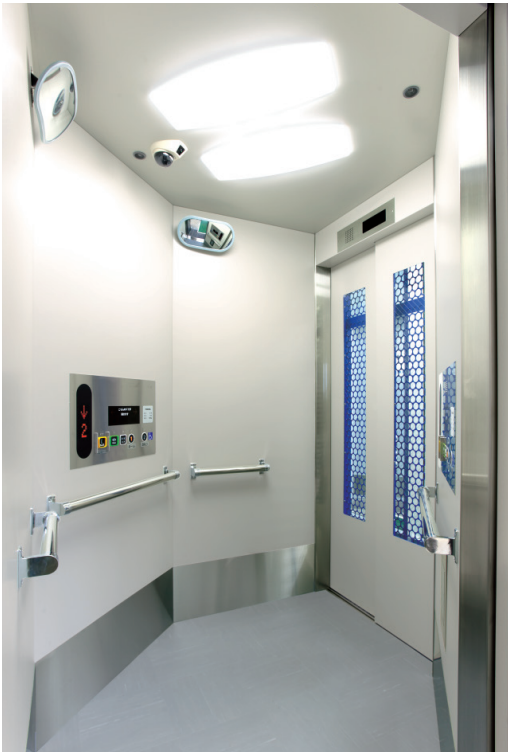
エレベーター・かご室
