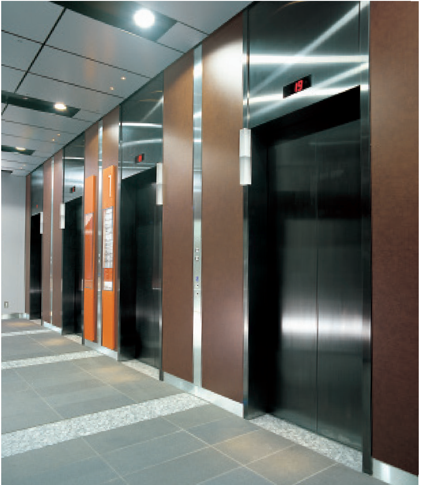
乗用 15人乗りエレベーター・1階ホール
