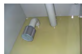
200 メッシュオイルフィルター タンク内取り付け状況
