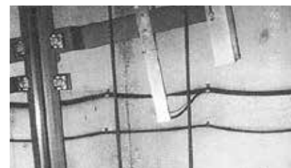
ロープの引っ掛けにより昇降路機器が損傷した例
