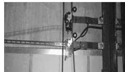
かご調速機ロープが昇降路機器に引っ掛かっている例
