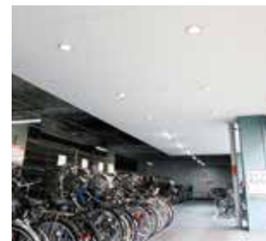
LED照明（駐輪場）
