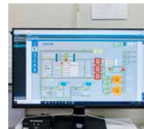
中央監視装置
