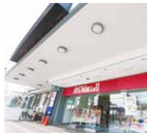
LED照明（1階エントランス）
