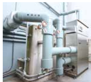
直結増圧ポンプ
