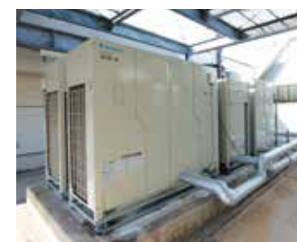
室外ユニット
