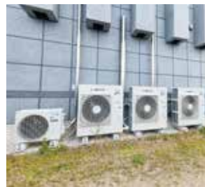
マルチエアコン室外機
