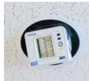
エレベーターホール(ウィルス抑制・除菌用UV照射器)
