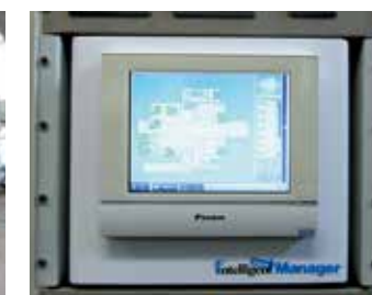
中央監視装置
