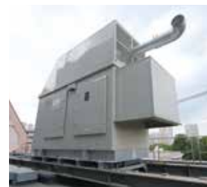
非常用発電機
