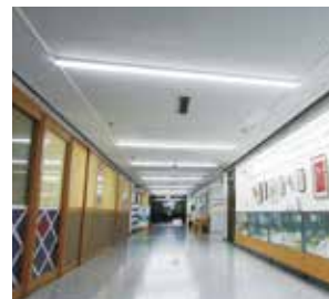
LED照明（地下廊下）
