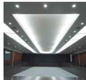
会議室内LED照明
