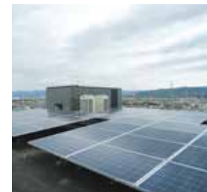
太陽光発電システム
