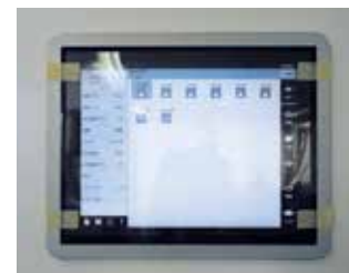
空調管理コントローラー（職員室）
