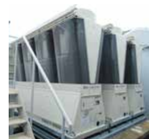
空調用熱源機
