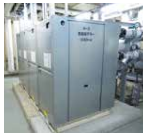
熱回収ヒートポンプチラー
