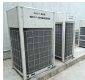
パッケージエアコン室外機
