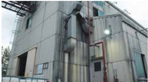
工場建屋外灯
