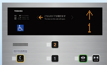
▲かご内操作盤
