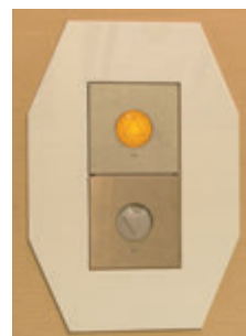
乗用15人乗 エレベーターのりばボタン リニューアル前
