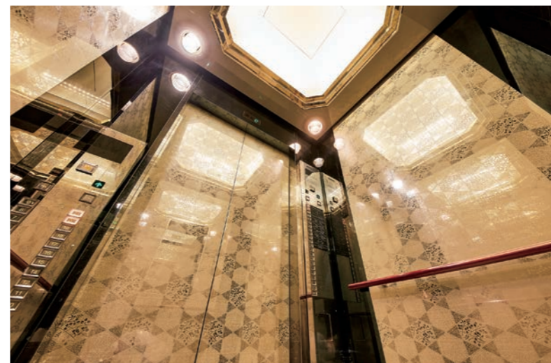
乗用15人乗りエレベーター・かご室天井(リニューアル前)
