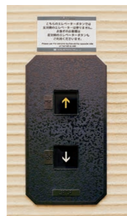
乗用15人乗りエレベーター・のりばボタン(リニューアル後)
