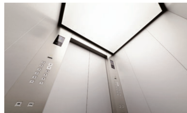
乗用13人乗りエレベーター・かご室天井(リニューアル後)
