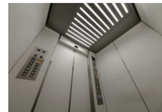
乗用(非常用)17人乗りエレベーター・かご室天井(リニューアル前)
