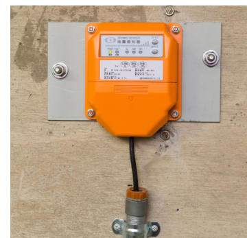
コートヒル取手の機械室（右）と地震感知器
