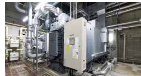
吸収式冷温水機
