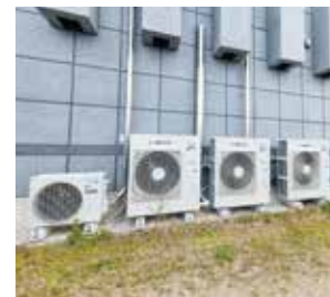
マルチエアコン室外機
