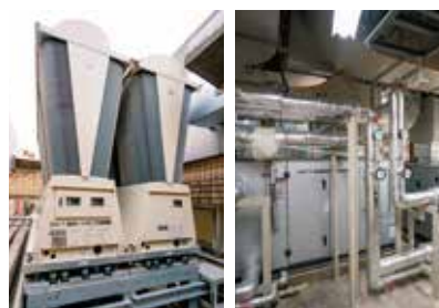
空調用熱源システム
