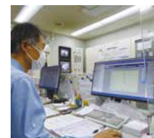
中央監視装置
