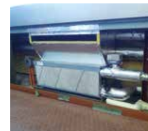
ファンコイルユニット
