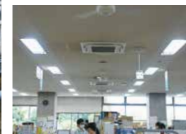
空調吹き出し
