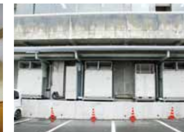
1～4F用マルチエアコン室外機
