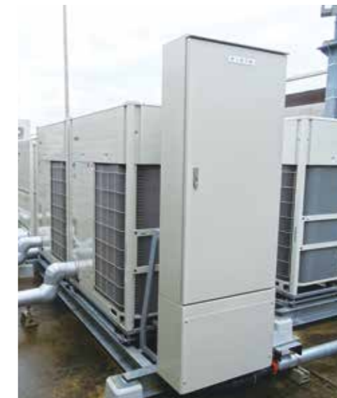
5F用空冷ヒートポンプチャラー
