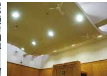
空調吹き出し（議場）
