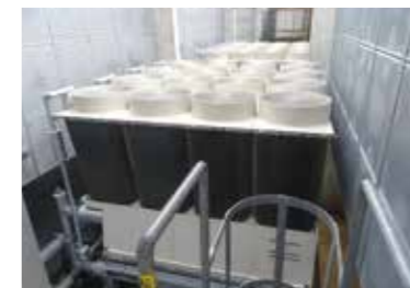
電気式空冷チラー
