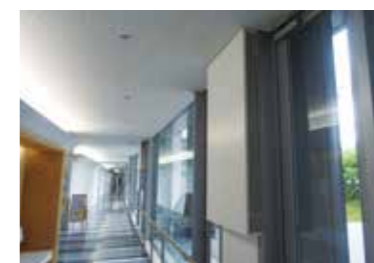
空調吹き出し
