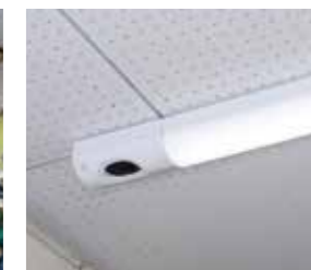
住之江公園 管理事務所窓口に カメラ付LEDベースライトを設置
