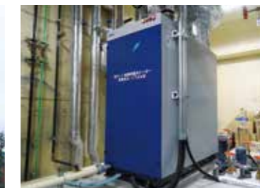
温水ボイラー
