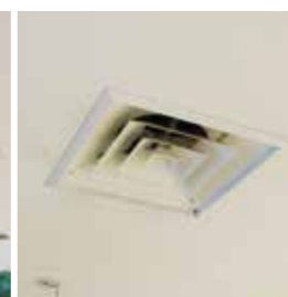
外気処理エアコン吹き出し
