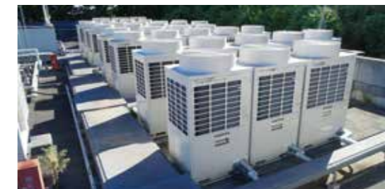
マルチエアコン室外機
