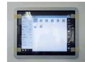
空調管理コントローラー (職員室)
