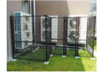
安全面に配慮しフェンスが設置された室外機
