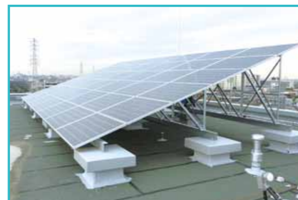
屋上に設置された太陽光パネル
