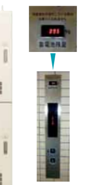
〔蓄電池残量計〕 各階に設置されており蓄電状況がリアルタイムでわかる
