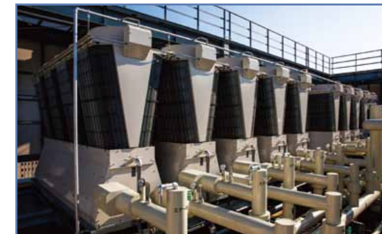
屋上に設置された「ユニバーサルスマートX」の室外機
