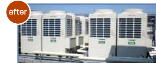
屋上に設置したビル用マルチ空調システム「スーパーモジュールマルチ」
