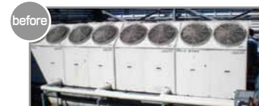
老朽化が目立つ空調室外機
