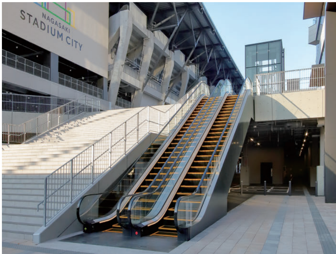
エスカレーター・1階 / 乗用15人乗りエレベーター・昇降路(コンコース)
