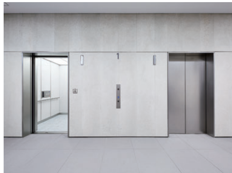
乗用20人乗りエレベーター・北館1階
