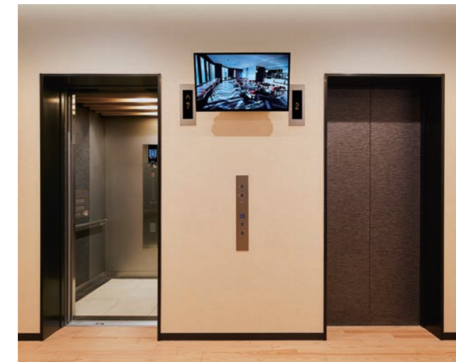
乗用15人乗りエレベーター・7階(東京豊洲 万葉倶楽部)
