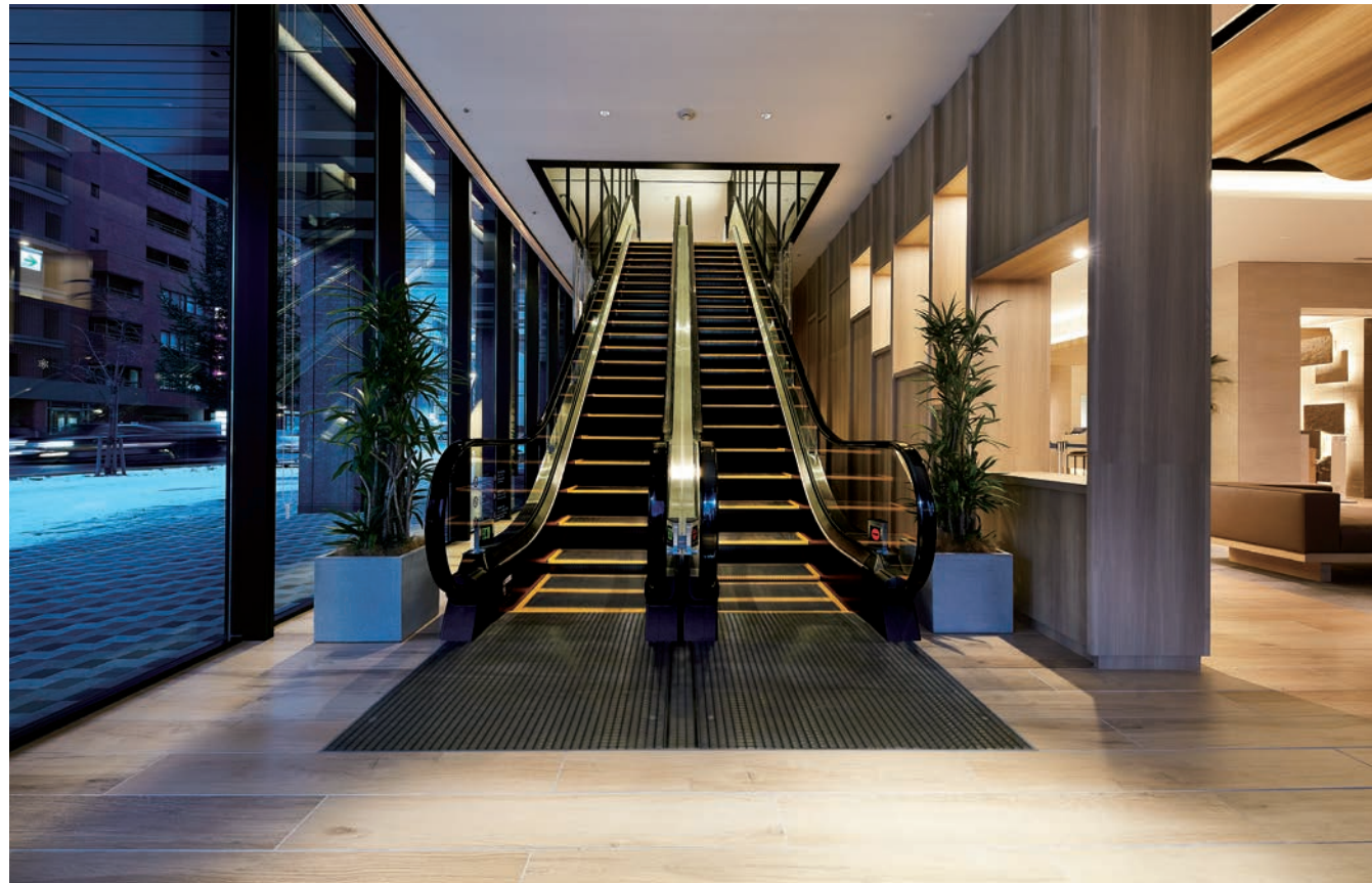
エスカレーター・1階
