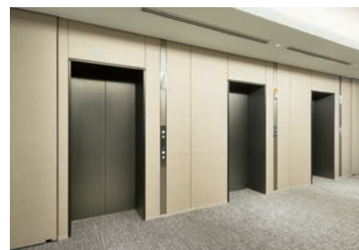
人荷用15人/乗用13人乗りエレベーター・3階
