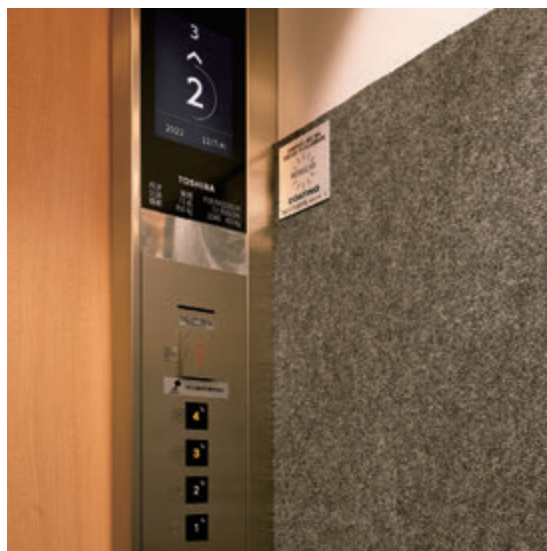
衛生対策として「非接触ボタン」と光触媒を使用した「消臭、菌・ウィルス抑制エレベーター用保護マット」を採用
