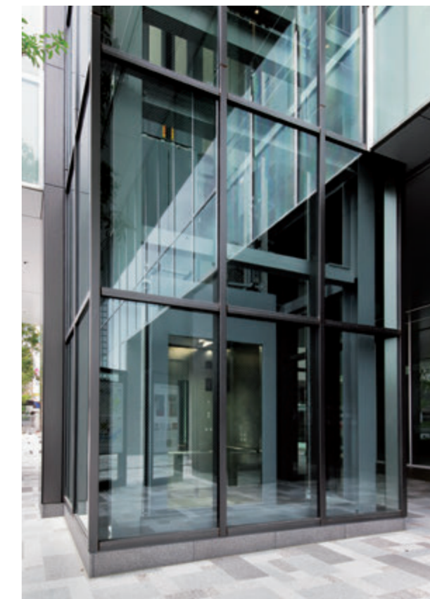
乗用(展望用)15人乗りエレベーター・1階昇降路
