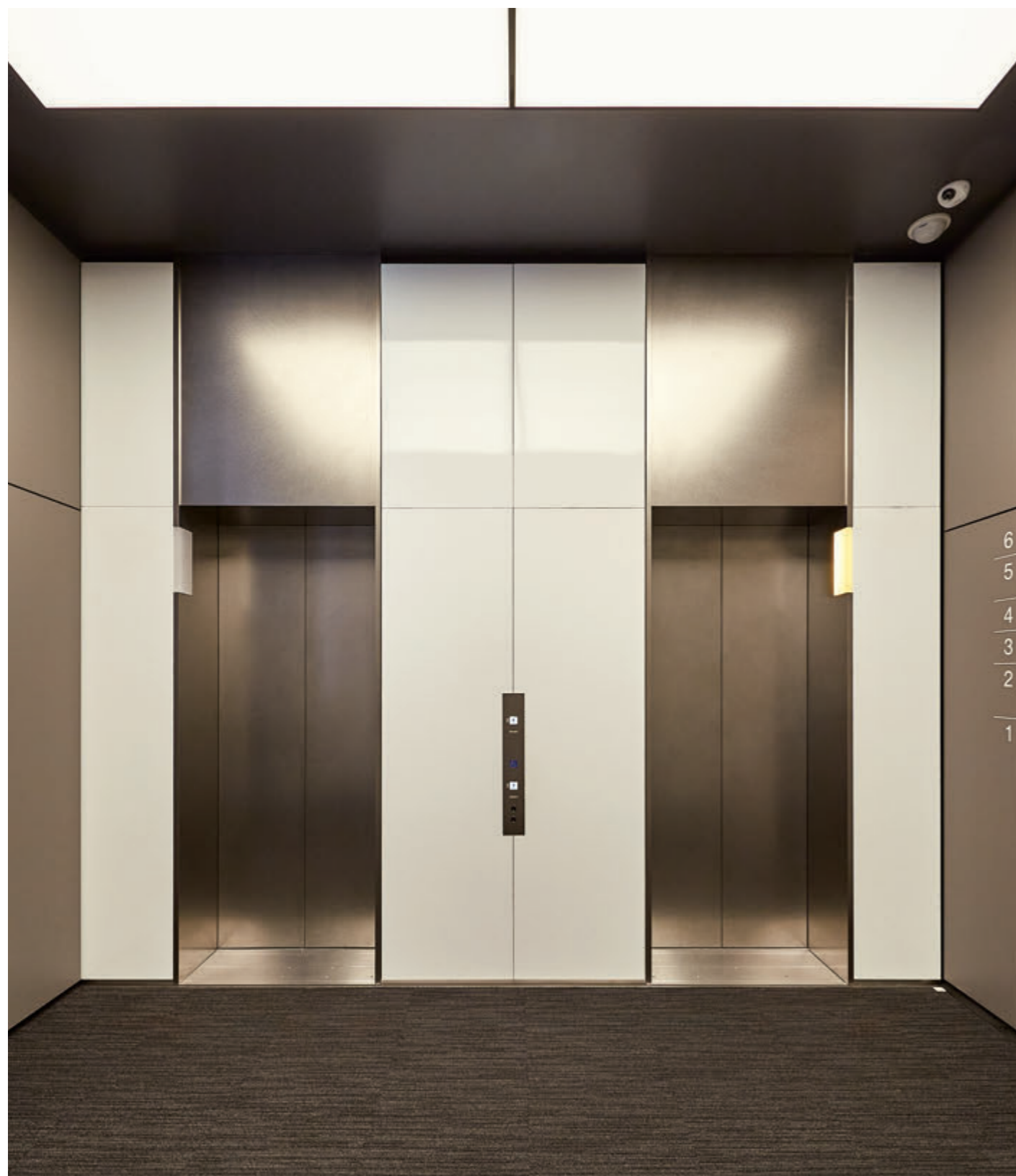
乗用15人乗りエレベーター・1階エレベーターホール
