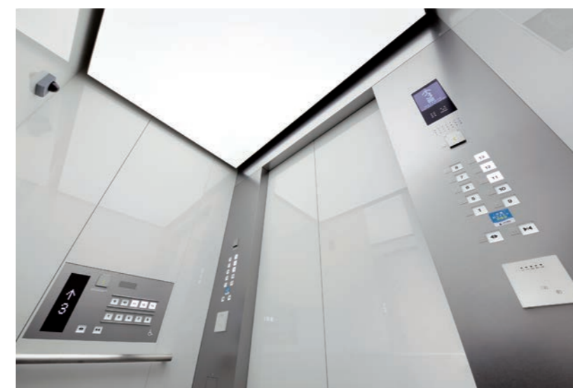
乗用17人乗りエレベーター・かご室天井
