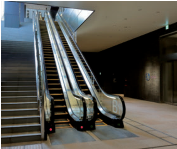
エスカレーター・地下1階
